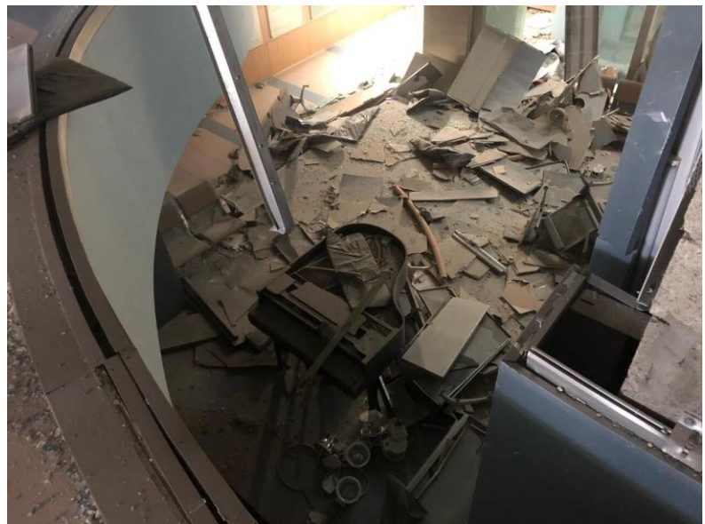
Figura 3: l'interno dell'ospedale Saint George, devastato dall'esplosione. Il tetto è crollato, tutti i pazienti sono stati evacuati.
